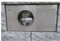
区総合庁舎敷地内壁面に設置
